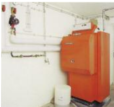
CO 2 - Einsparungsprogramm beispielhaft umgesetzt in den Häusern Ringstraße 24 und 28 bis 36
